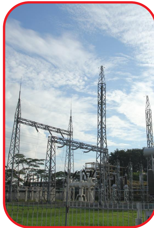
Penyediaan Tenaga Listrik dan Uap
