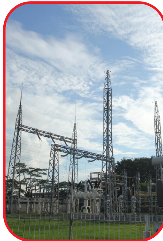
Penyediaan Tenaga Listrik dan Uap
